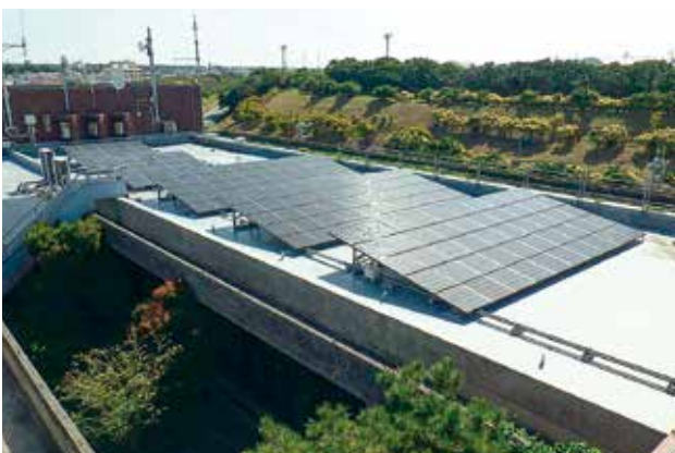
役場庁舎太陽光発電設備
